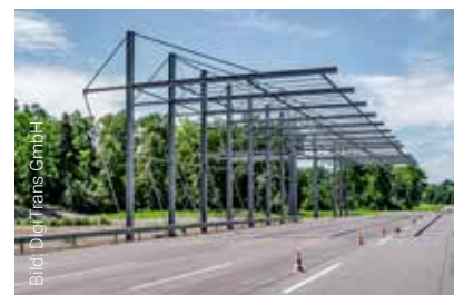
Die Stahlkonstruktion der rund 100 m langen und 13 m hohen Outdoor-Beregnungsanlage auf der Teststrecke in St. Valentin.
